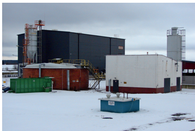
Węzeł przetwarzania osadów (w tle widoczna suszarnia osadów).
