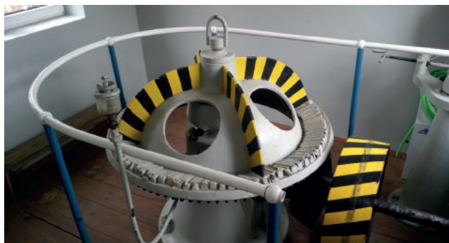
Odrestaurowana turbina wodna. W przeszłości było to najważniejsze urządzenie zaopatrujące wylęgarnię w wodę umożliwiającą inkubację ikry.
