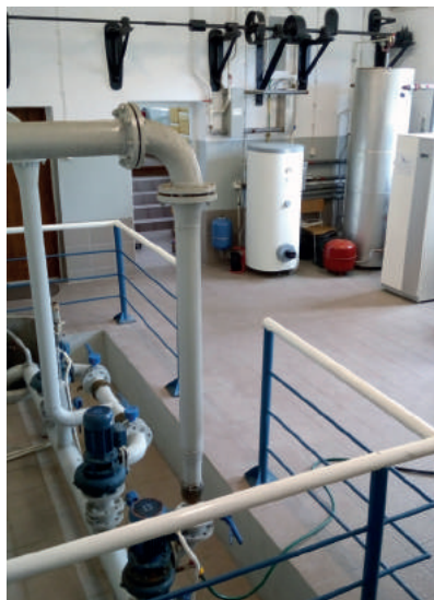
Maszynownia i niektóre znajdujące się tam urządzenia. Od 1999 r. wylęgarnię ogrzewa pompa ciepła, która zastąpiła starą „westfalkę” oraz piec akumulacyjny. Wodę tłoczą pompy elektryczne, a nowy agregat prądowłóczy zapewnia awaryjne zasilanie urządzeń, gdy brakuje prądu w sieci. Na ścianie u góry zachowane i odnowione stare przekładnie pasowe napędzające w przeszłości pompy i generator prądu.
