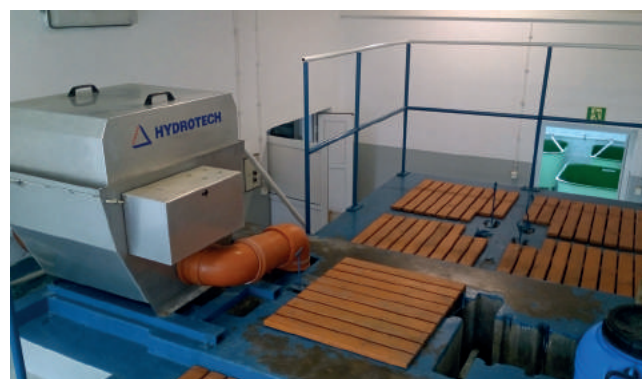
Sekcja oczyszczania wody. Na pierwszym planie „nowe”, kompaktowe, automatyczne mikrosito stojące na „starym” 8-komorowym filtrze, wymagającym obfitego, żwirowego wypełnienia. W głębi fragment zmodernizowanej podchowalni z basenami narybkowymi.
