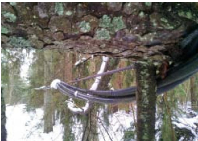
Powalone wiatrem drzewa padały także na kablowe linie średniego napięcia w obwodach ochronnych Lipowe i Powaty.
