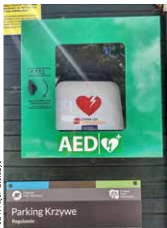
Na parkingu przy Dyrekcji WPN w Krzywem zainstalowaliśmy automatyczny defibrylator zewnętrzny (AED).
